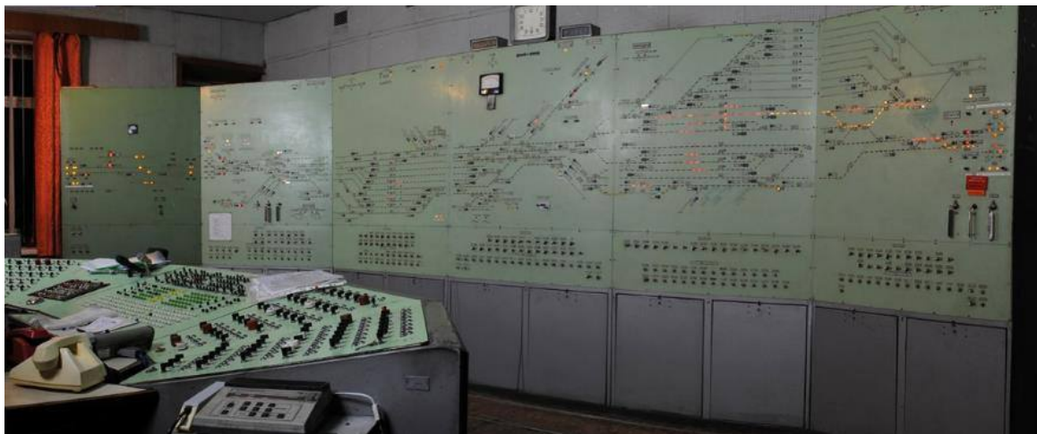
Рисунок 1 – табло дежурного по станции, пост ЭЦ.
